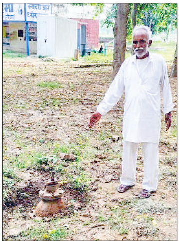
मंडी अटेली। जलघर की मुख्य टंकी का खराब वॉल्व दिखाता ग्रामीण।
